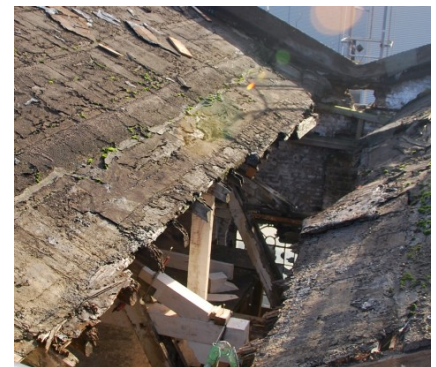
Eingestürzte Kehle, Ende 2011
