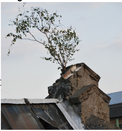
Vor der Sanierung wuchsen Bäume am Sügiebel und zerstörten die Steine.
