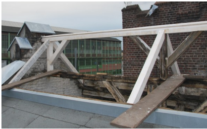
Die Firstfette musste komplett ausgetauscht werden, da u. a. der Anschluss an den Sügiebel zerstört war.
