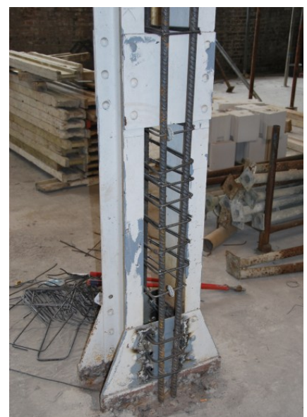
Stahlstütze mit eingebauten Monierisen
