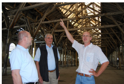
Architekt Rainer Dittrich, Dr. Dietmar Rudert von der Deutschen Stiftung Denkmalschutz und Vorsitzender Martin Menke begutachten die Bauschäden.
